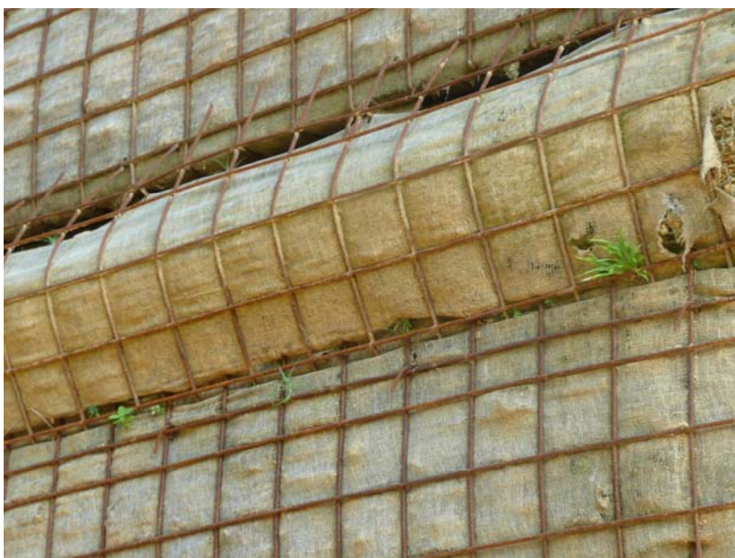
I nuovi terrazzamenti in terra armata crollati o impanciati e sicuramente prossimi al crollo
